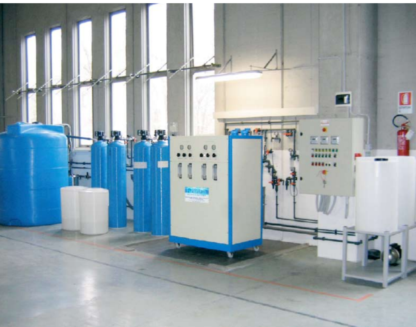
Impianto di potabilizzazione
