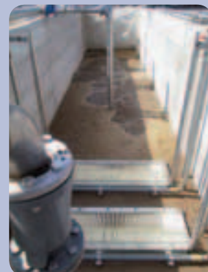
Impianto biologico MBR
