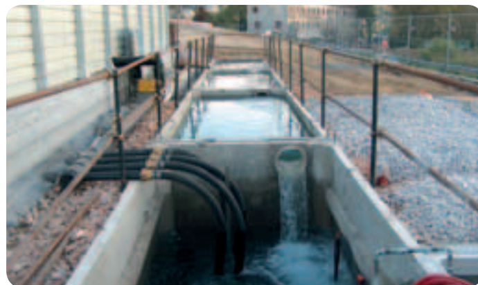
Vasche di decantazione
